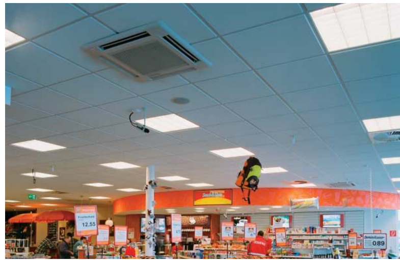
Deckenauslass im Shopbereich
