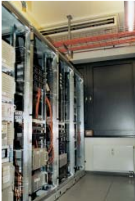
Die Abwärme aus den Serverräumen ...
