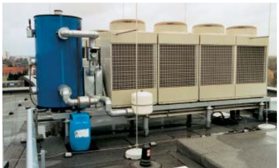
Anbindung eines Pufferspeichers zur Versorgung des Küchen-Zuluftgerätes
