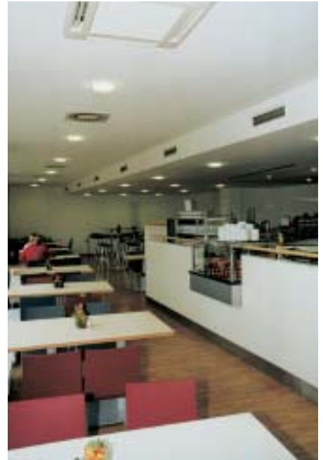
... wird zur Erwärmung der Küchen- und Kantinenzuluft verwendet
