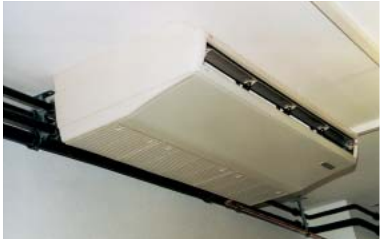
Deckenunterbaugerät zur Kühlung des Serverraums
