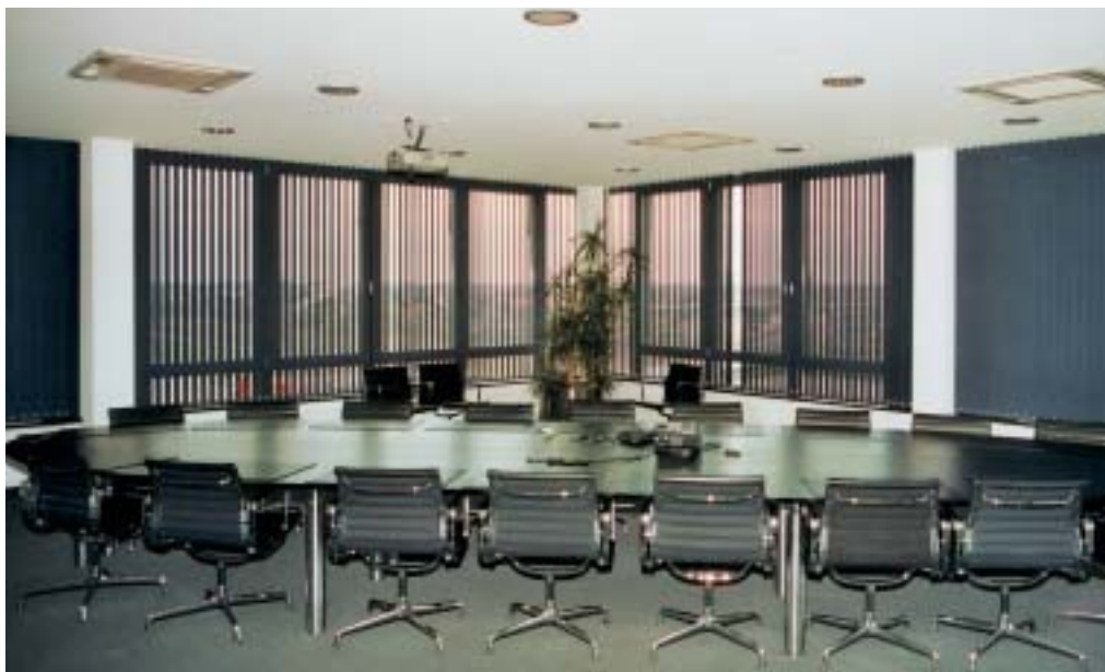
Der exklusiv gestaltete Konferenzraum wird mit Deckenkassetten gekühlt
