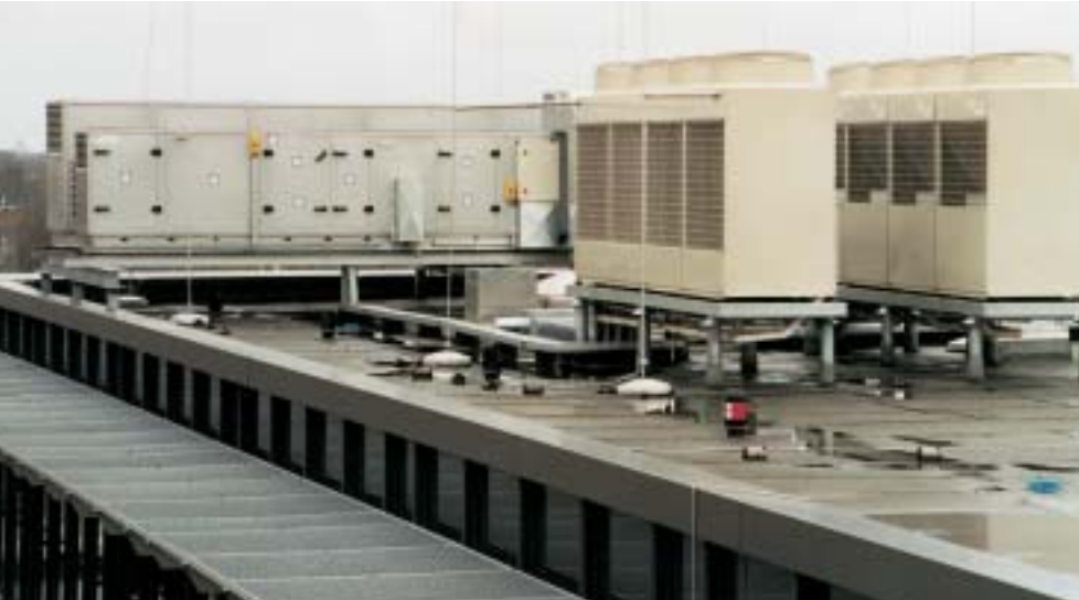
Dachansicht der Bank mit einem Teil der 18 Außengeräte
