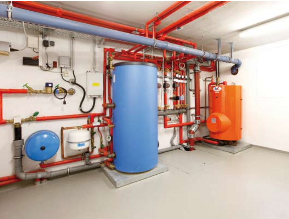
Die Heizenergie und die Warmwasserbereitung werden ausschließlich über regenerative Energien bereitgestellt
