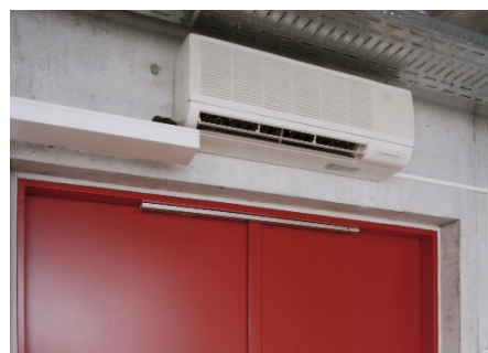
Einbausituationen der Wandgeräte im EGZ Ingolstadt
