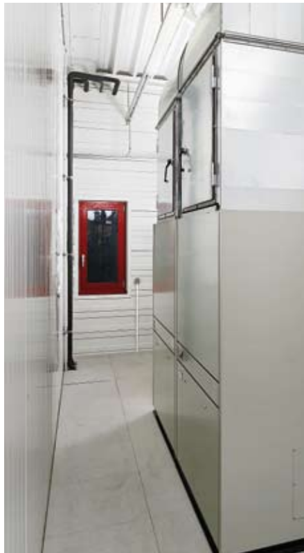
Die Klimaschränke sind über Luftkanäle mit dem Serverraum verbunden
