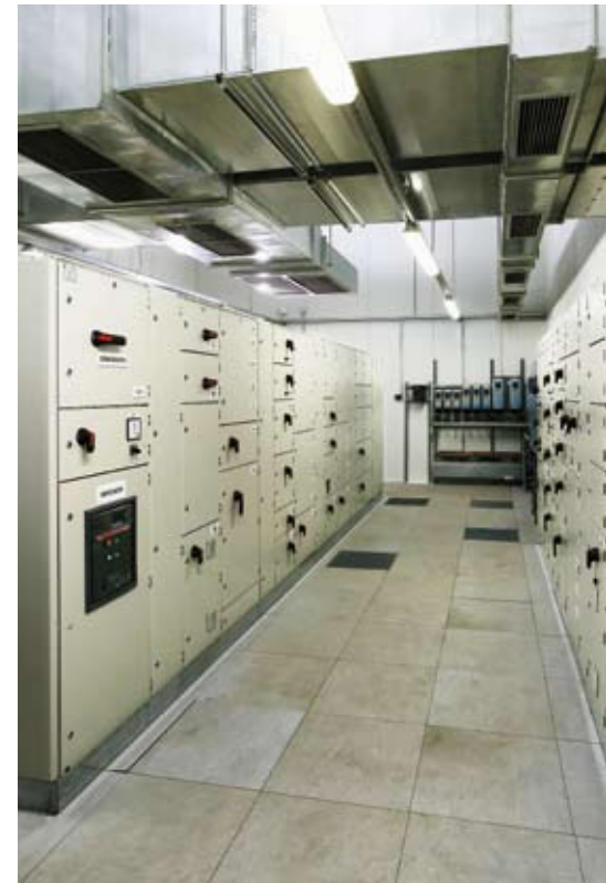
Im Technikraum des Biomasse-Kraftwerks wird die kühle Luft in den Doppelboden eingeblasen
