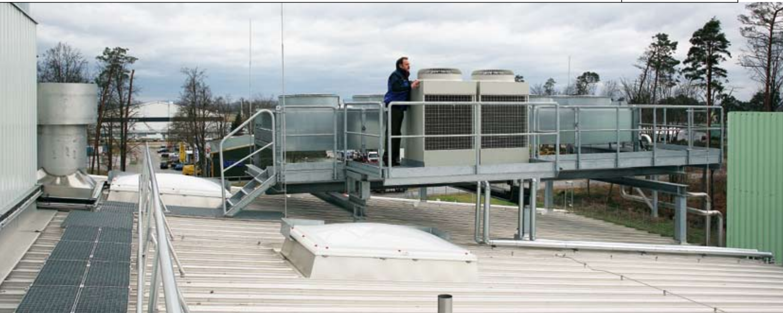
Die Außengeräte für die EDV-Klimaschränke wurden auf dem Dach des Biomasse-Kraftwerks installiert
