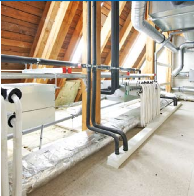
▲ Zwei BC-Controller im Spitzboden übernehmen die bedarfsgerechte Kältemittelverteilung.
