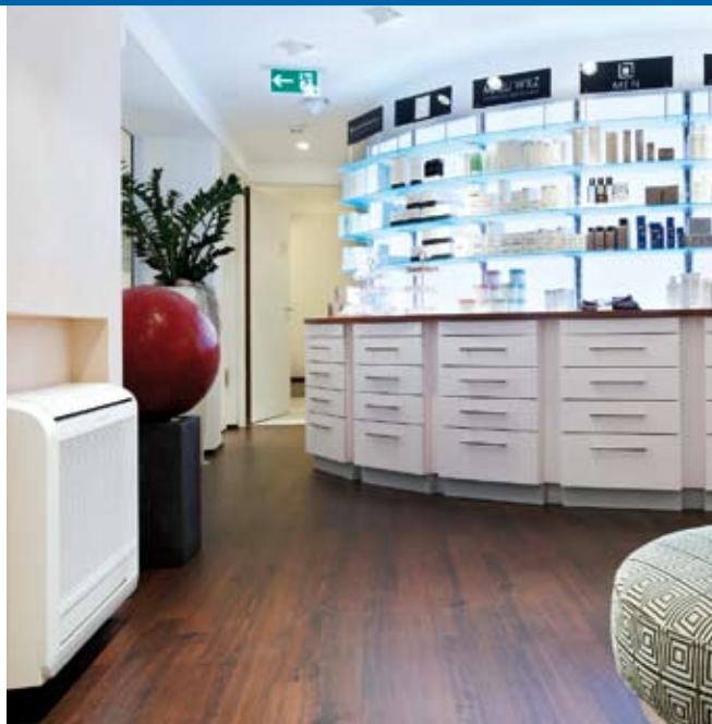
▲ Bereits im Eingangsbereich sorgt ein Truhengerät vom Typ PFFY-P32VKM-E für Wohlfühlklima und entspannende Atmosphäre.
