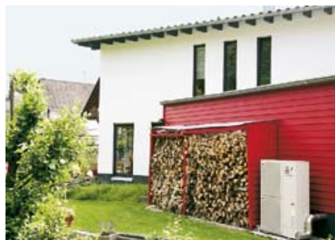
Klimageräte einer Splitanlage außen...
